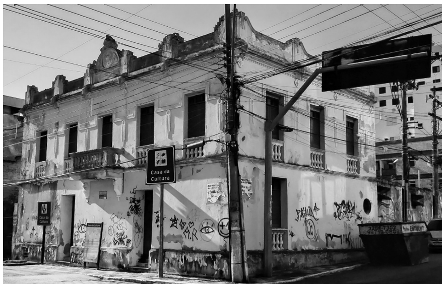
Figura 1 – Casa da Cultura de Guarapari: em estado de deterioração e abandono
